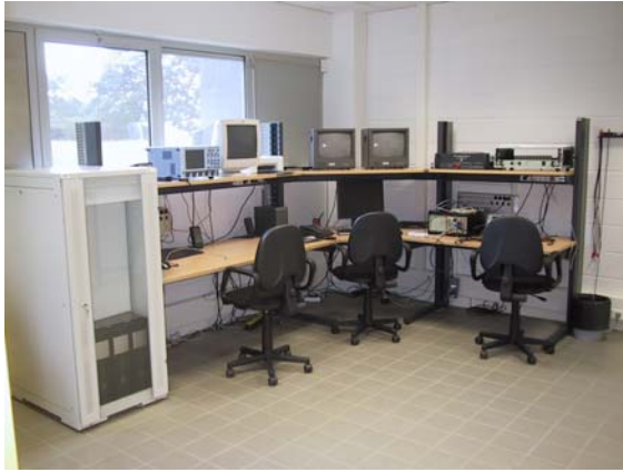
Salle de contrôle (SC)
